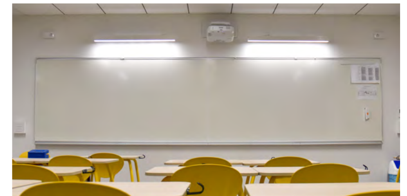
WALL LIGHTING ILLUMINAZIONE DA PARETE
